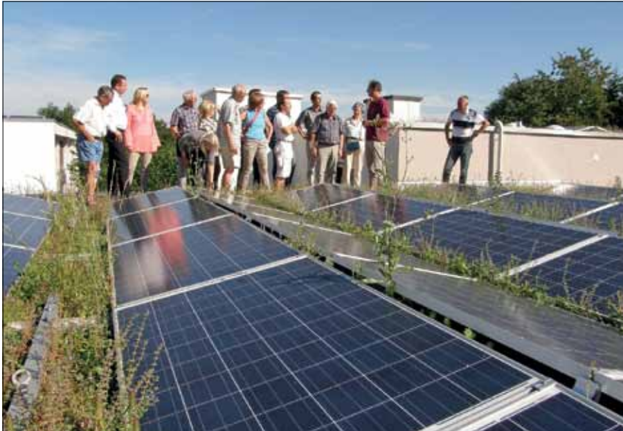
Hoch auf dem Schulhausdach, bei den Solarmodulen, erklärt Andreas Dreisiebner den Gästen die Funktion der Photovoltaik-Anlage.
